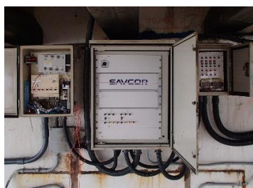
図. 12 直流電源装置
