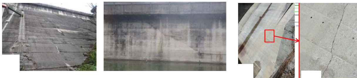
図-8 堤体に生じた劣化（左2枚：鏡ダム 右2枚：永瀬ダム）
