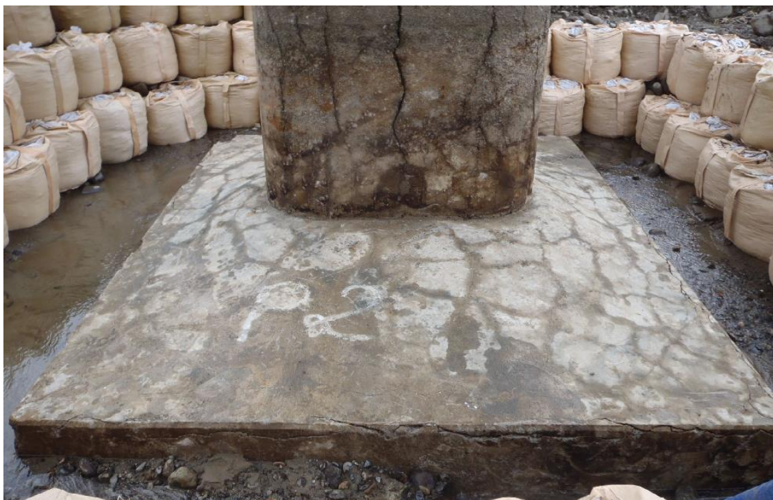
P 2 橋脚 ( P 3 側 ) 柱下及びフーチングの状況
