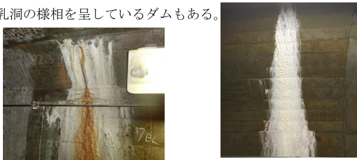
図-6 監査廊内のエフロ・錆汁の析出（左：永瀬ダム 右：鎌井谷ダム）
