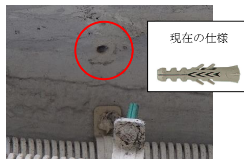
図.26 配管材固定ビス抜け落ち
