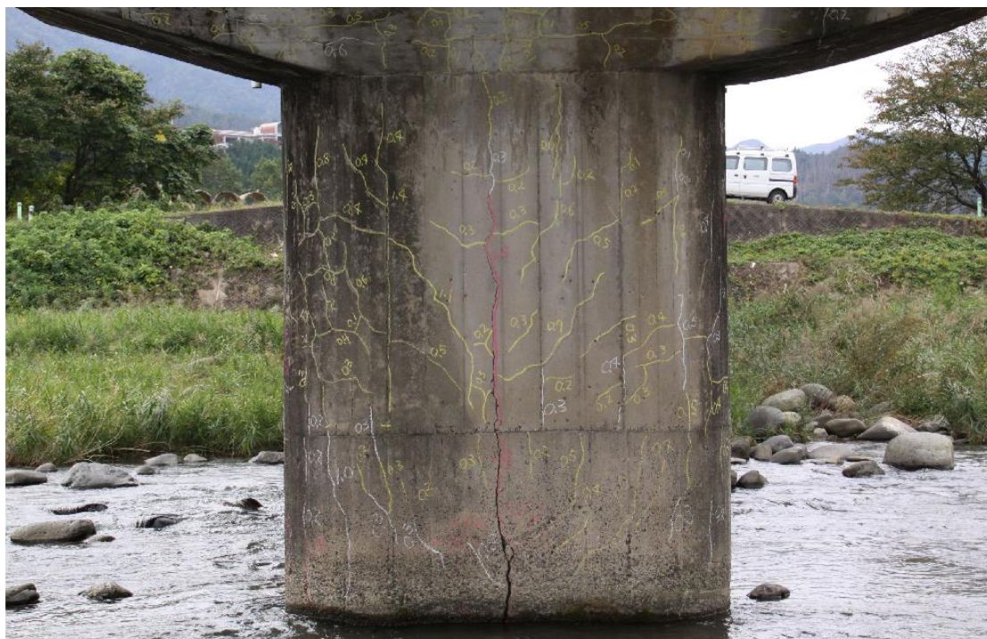
P2橋脚 柱部分のひび割れ発生状況（右岸側）
