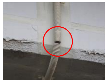
図.24 配管材の割れ
