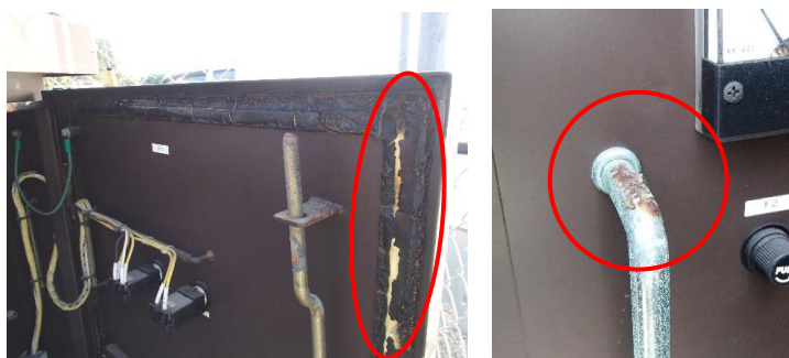
図.25 直流電源装置の劣化
