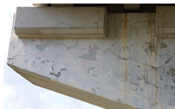
写真-3 梁側面部のひびわれ
