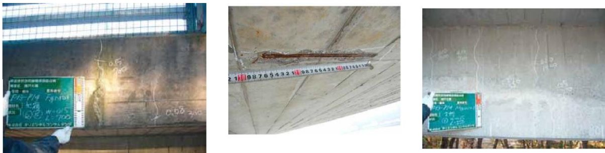
図-4 確認された劣化状況写真
