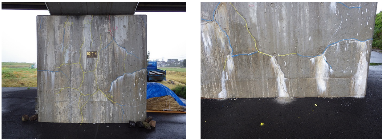
写真-9 RC巻立て部のひびわれ状況（ひびわれ最大幅1.0mm）
