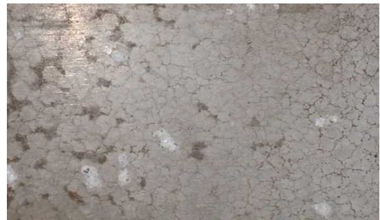
写真-1 火災による亀甲状の微細ひび割れ
