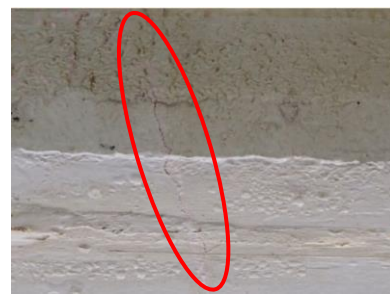
図.19 G2桁のひび割れ
