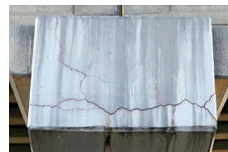
写真-4 梁先端部のひびわれ (最大ひびわれ幅：7.0mm)
