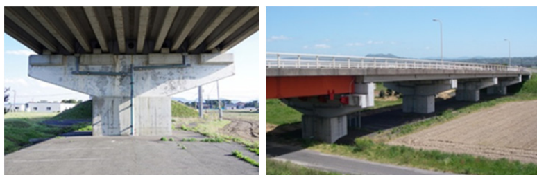
写真-1 ASRが生じている陸上部の橋脚
