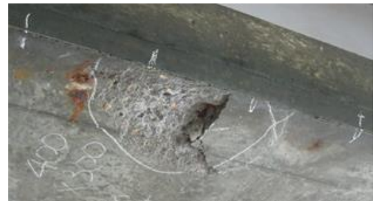
図.2 G3桁底面の剥落部
