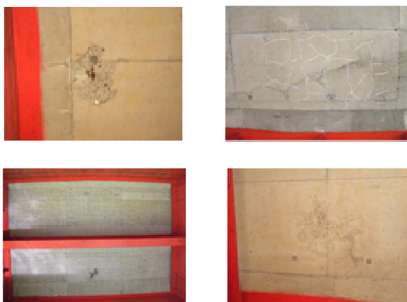
図-1 橋梁床版の劣化状況
