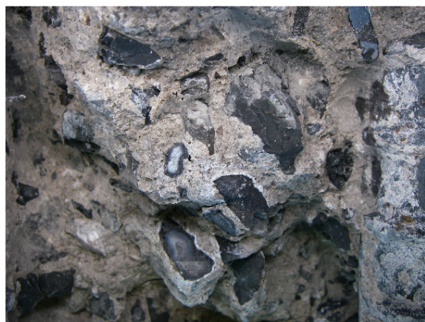
写真-6 はつり直後のコンクリート表面 (骨材からゲルらしき析出物が染み出している) (コンクリートが湿っており、水を含んでいる)
