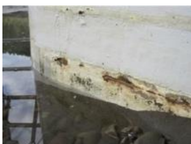
図.21 陽極被覆モルタル変色
