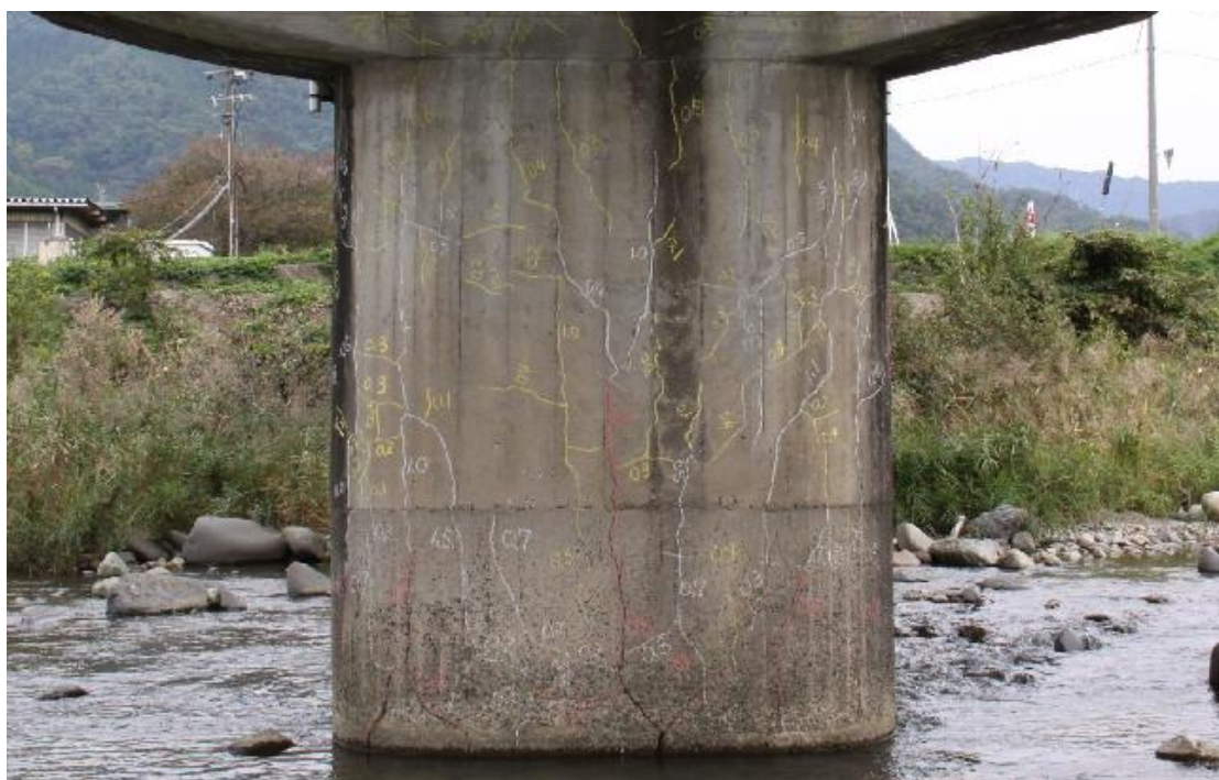
P2橋脚 柱部分のひび割れ発生状況（左岸側）
