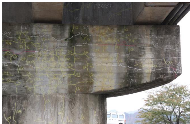
P2橋脚 梁部分のひび割れ発生状況（右岸側）
